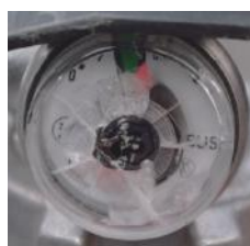
× 指示圧力計の損傷
