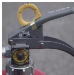
× 表示装置の脱落
