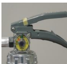
× 安全栓の脱落
