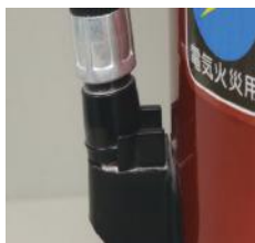
× 消火薬剤の漏れ
