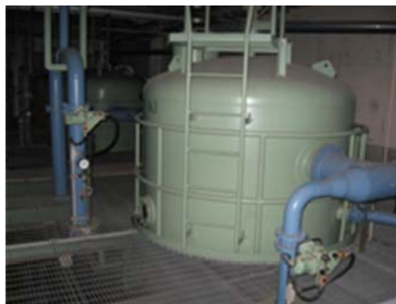
図5-20 七里ガ浜浄化センター砂ろ過施設
