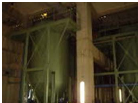
図5-19 山崎浄化センター砂ろ過施設
