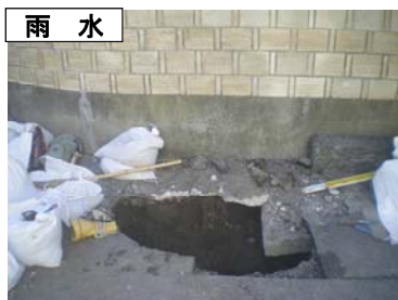
管渠崩壊による道路陥没
