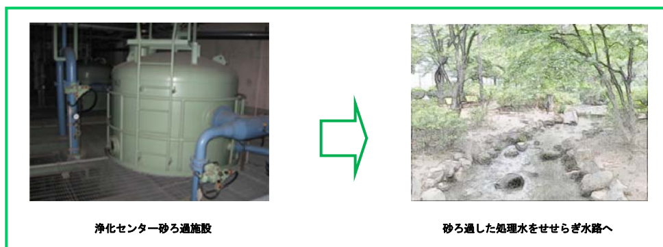
図 6-17 高度処理水の親水性水路への利用
