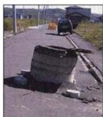
マンホールの浮上
