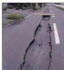
管路部の道路陥没
