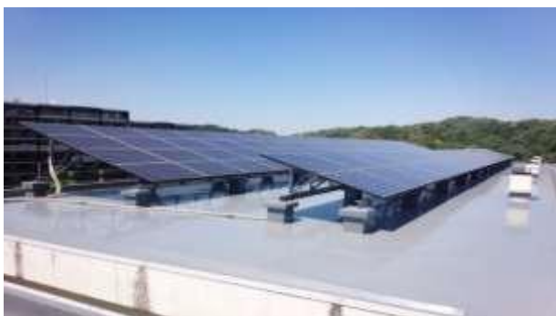
太陽光発電屋根貸し事業で設置された太陽光パネル(岩瀬中学校)
