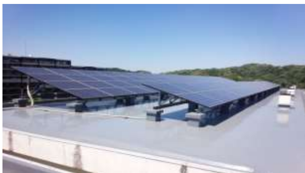
太陽光発電屋根貸し事業で設置された太陽光パネル（岩瀬中学校）
