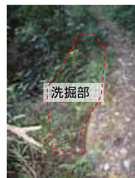
現況洗掘箇所（位置(8)）
