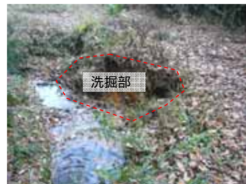
現況洗掘箇所（位置(5)）
