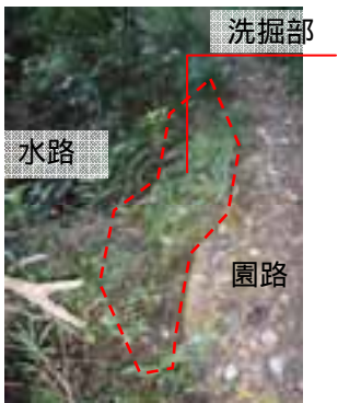
現況（水路洗掘箇所に近接する園路）
