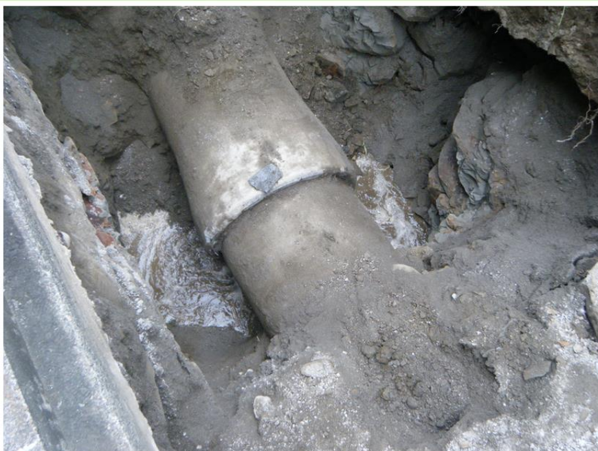
稲村ガ崎の崖の崩落により 下水道管が破損
