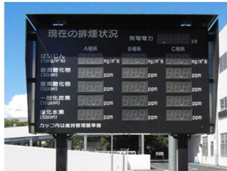
公害監視盤(平塚市)
