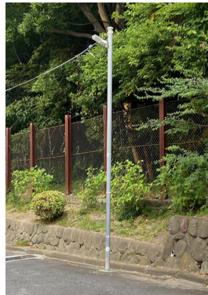
【柱（電柱以外）に設置された防犯灯】
