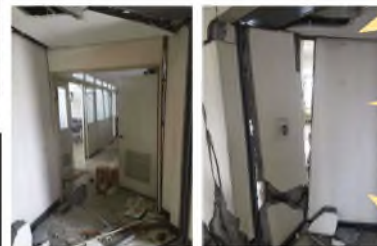
5階内部(通路棟と本庁舎接続部分) ※庁舎棟と通路棟それぞれの傾きにより接続部分が破断。壁の隙間から外が見える。
