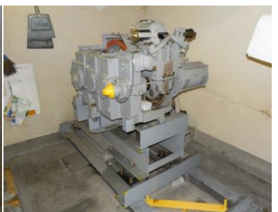
2号昇降機（巻上げ機） ； カゴ室を含め全面更新されている
