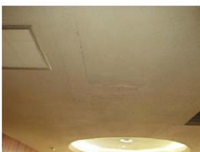
2階 議場ロビー天井 ；ボードのひび割れ、塗装の劣化が進行している
