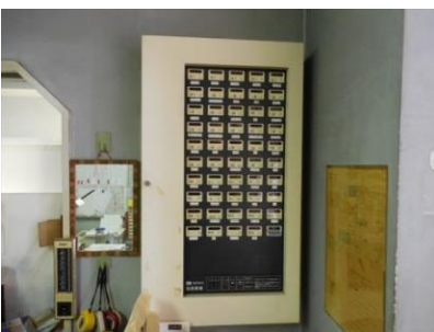
火災報知設備 副受信機 ；竣工時の機器。経年劣化が進行している
