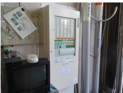
火災報知設備 受信機 ；2014年に更新されている
