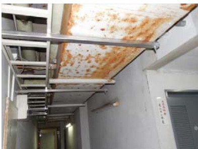
電気ダクト ；竣工時の機器が使用されている 発錆、腐食が進行している
