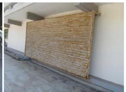
給排気口目隠しルーバー ；発錆が著しい。取付金物は腐食が進行している
