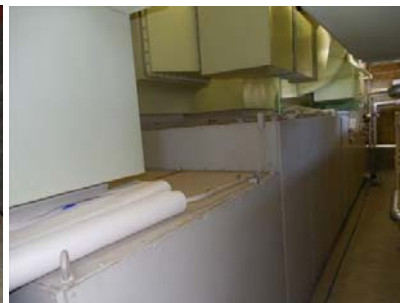
空調機外観 ；竣工時の機器が使用されている
