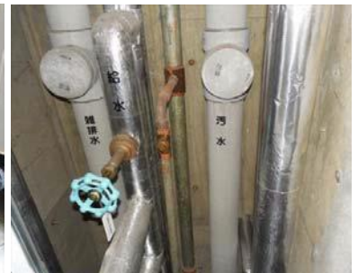
給水管、雑排水管、汚水管 ；平成21年に更新改修された
