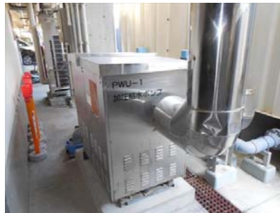
加圧給水ポンプ ；平成21年に新設設置された
