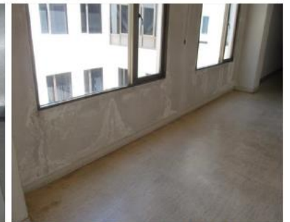
壁仕上げ（モルタル、塗装仕上げ） ；外壁漏水跡が未改修
