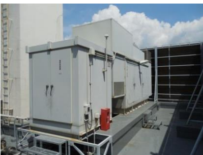
非常用発電機 ； 2008年に屋上へ移設し更新改修された
