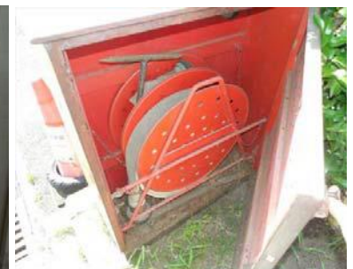
ホース格納箱 ；箱体の腐食が著しい。ホースの経年劣化が進行している
