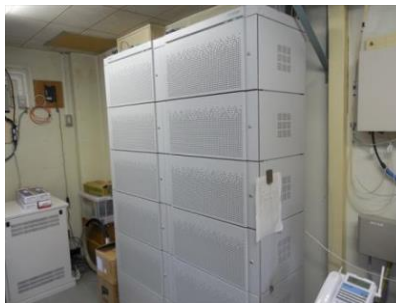
電話交換機 ；更新されている
