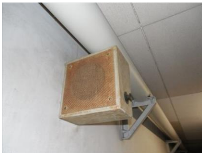
放送設備 スピーカー ；竣工時の機器。経年劣化が著しい
