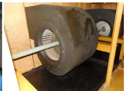
空調機内部 ；内装、機器類は更新されている
