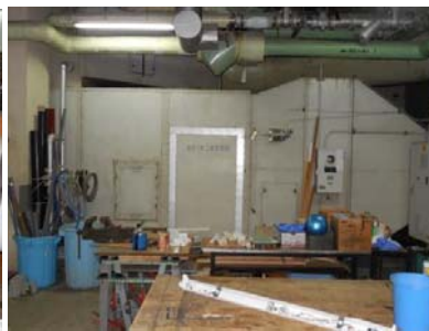
空調機外観 ；竣工時の機器が使用されている
