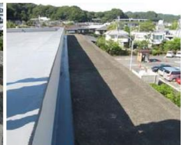
庇上部の防水未改修部分 ；躯体内部鉄筋の発錆が懸念される
