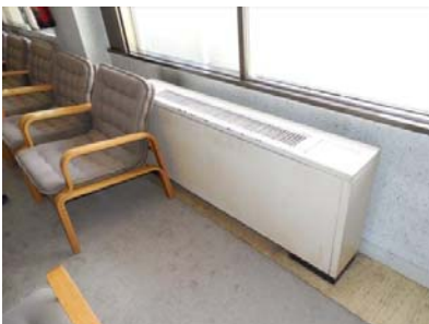
ファンコイルユニット ；竣工時の機器が使用されている
