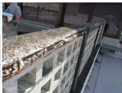
有孔PC板手すり壁の劣化状況 ；爆裂、内部鉄筋の発錆が多数確認される
