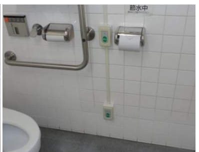
トイレ呼出し設備 ；2014年に設置された。不具合は確認されない
