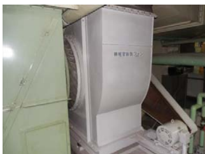
吸気ファン ；竣工時の機器が使用されている
