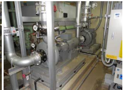
冷温水ポンプ ；平成18年に更新された。不具合は確認されない
