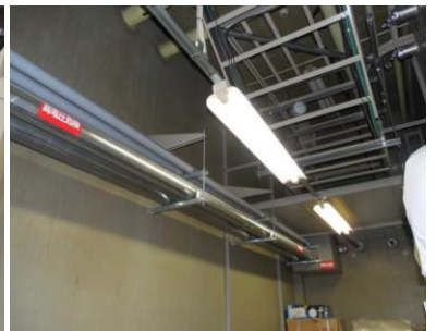
幹線 ； 2008年に更新改修された
