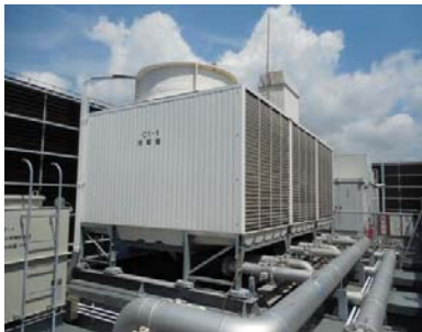
クーリングタワー ；平成18年に更新された。不具合は確認されない
