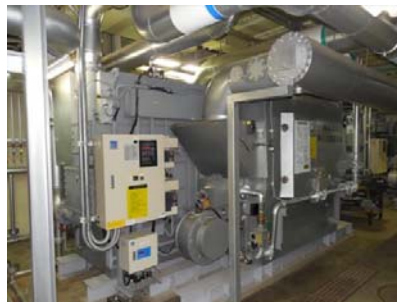
冷温水発生器 ；平成18年に更新された。不具合は確認されない
