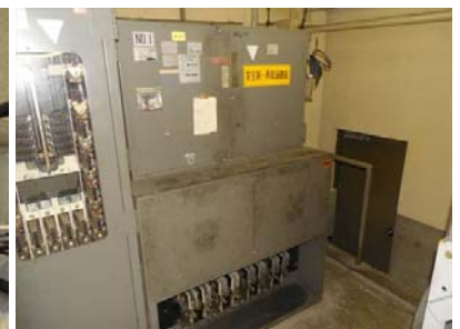
1号昇降機 制御機器 ；竣工時の機器が使用されている
