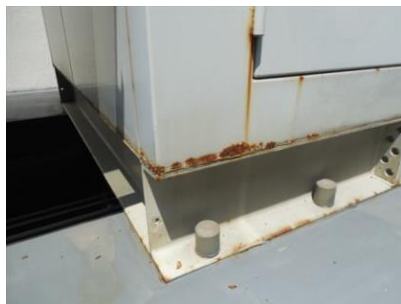
非常用発電機 ； 2008年に屋上へ移設更新改修された。箱体に発錆がある
