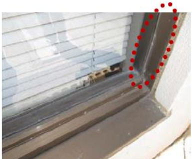
アルミサッシ周囲のシーリング材 ；劣化の進行が著しい
