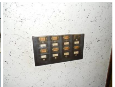
埋め込み型照明スイッチ ； 竣工時の機器。経年劣化が進行している
