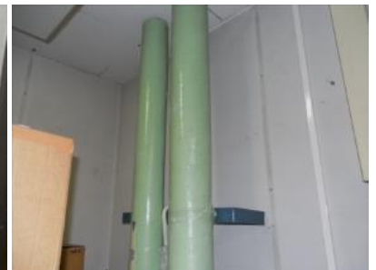
汚水、雑排水管 ；竣工時の配管が使用されている
