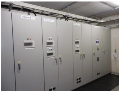
受変電設備（屋内キュービクル） ； 2008年に更新改修された
