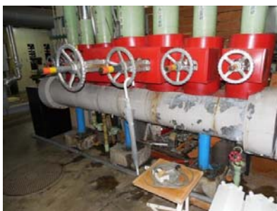
空調配管ヘッダ ；竣工時の機器が使用されている
