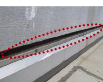
防水立上り上端のシーリング材 ；劣化の進行が著しい
