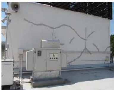
塔屋外壁の劣化状況 ；シーリング補修が実施されている
