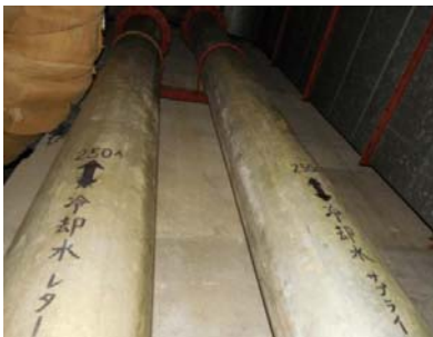
冷却水配管 ；竣工時の配管。内部腐食は重篤と考える
