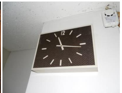
電気時計 ；竣工時の機器。不具合は確認されない
