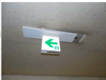
避難口誘導灯 ； 改修されている
