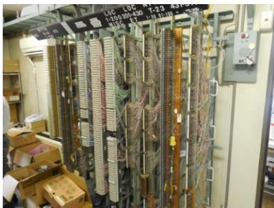
MDF ；竣工時の機器。外観上不具合は確認できない
