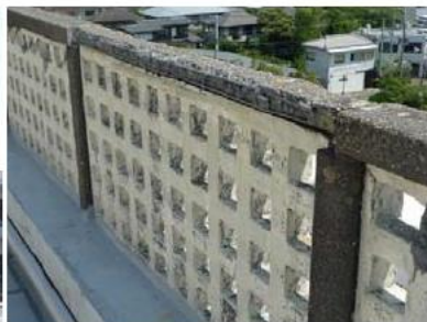
屋上手すり壁の破損状況 ；老朽化により崩壊が懸念される
