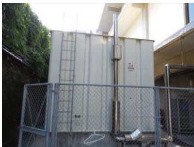
受水槽 ；平成21年給水システム更新に伴い地上型に更新改修された
