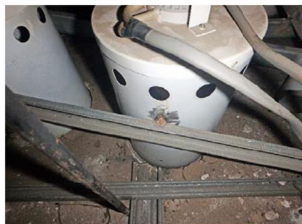
写真34；照明器具は野縁受け同材と溶接され、天井の吊りボルトや野縁受けに支持されており、単独での支持は無い。
