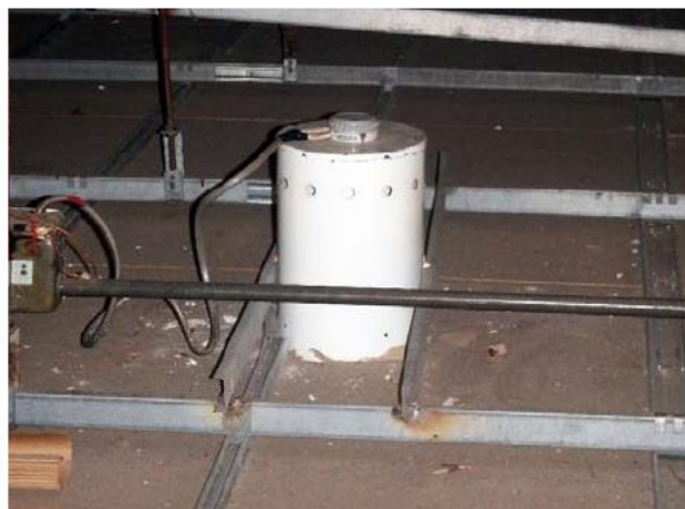
写真30；開口補強部（開口補強なし）設備機器 は野縁受け同材に溶接され、周囲の野 縁受け上に載せられ溶接されている。
