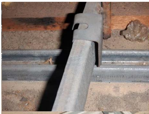
写真23；クリップの緩みが発生している。
