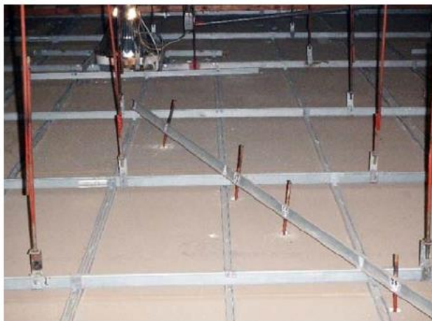
写真31；野縁受けの上に溶接されている間接照明機器の吊り元（野縁受け同材）が倒れている。ボルトも傾いている様子。
