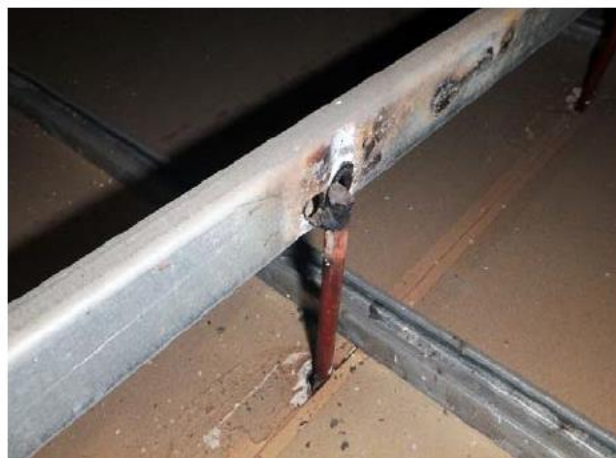
写真32；設備の吊り元と吊りボルトの溶接部。 （防錆処理なし）
