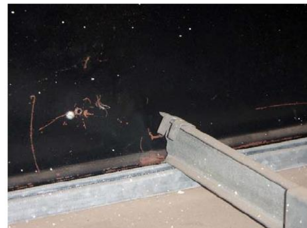
写真24；端部のクリップ上部爪の開きを確認した。
