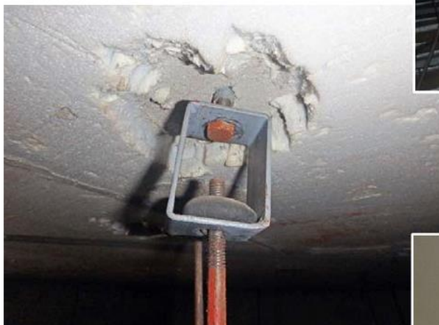
ダクト防振吊りの状況
