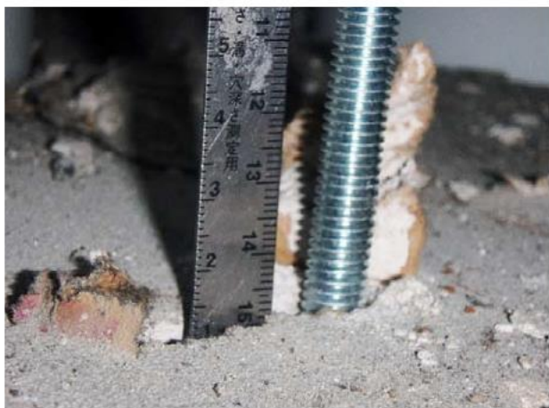
写真25；仕上げ材（捨て張り） 施工当時の状況から9mm2層と想定する ボルトが動いて貫通孔が広がっている
