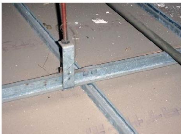
写真21；従来型シングルクリップ（腹掛け） 地震力等の外力は考慮されていない。
