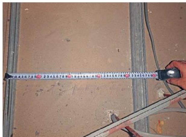
写真20；一部野縁の間隔が400mm程度になっている。
