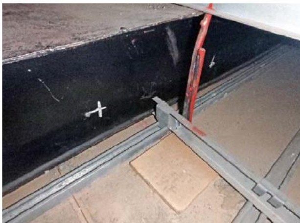
写真17；吊りボルト下端に溶接された野縁受け。
