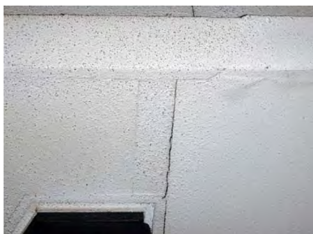
写真5；天井面（傍聴者席後方）壁の出隅近傍の仕上げにクラックが発生。
