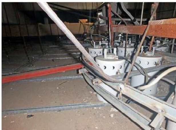
写真35；天井中央部の照明器具の周囲の状況。 （R加工された野縁受けが廻されている）
