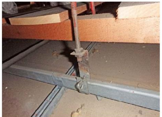
写真16；一般的なハンガーの状況。 （ピンによる開き留め、又は溶接）
