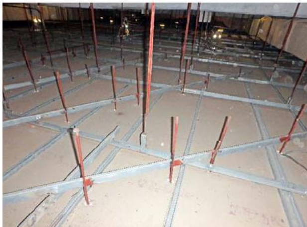
写真19；野縁は概ね360mm間隔に設置されている、吊りボルト・野縁受けは概ね900mm間隔、水平・斜め補強はない。
