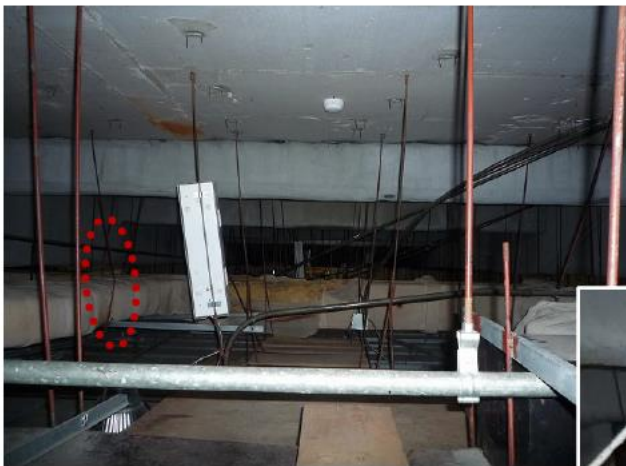
ダクト～天井吊りボルトの接触状況 -1
