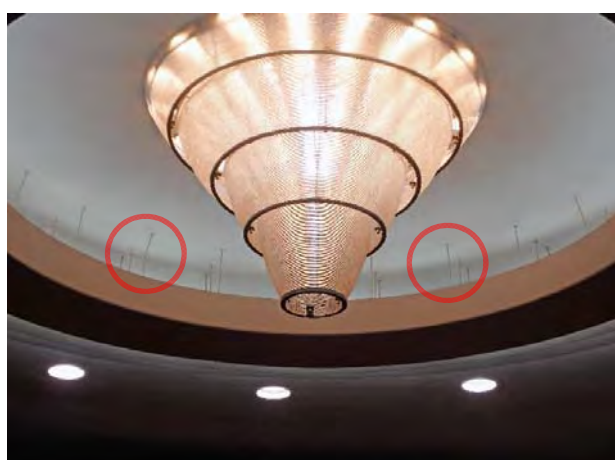
写真6；照明設備の吊り材（天井中央）湾曲している吊り材がある。
