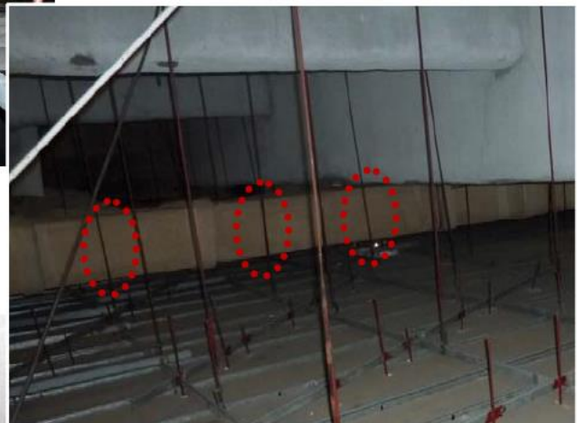
ダクト～天井吊りボルトの接触状況 -2
