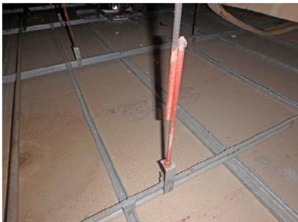
写真15；一般的な吊りボルトの状況。 （溶接で継ぎ足されている 天井ふところ：1.64m）
