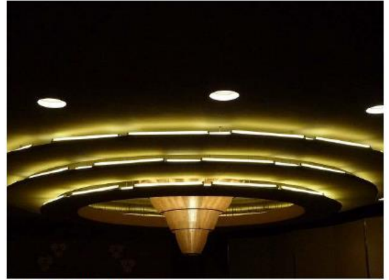
建築化照明 側面
