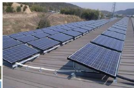
屋根上の設置事例 -2
