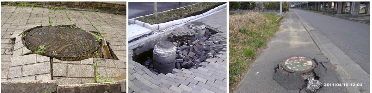
マンホール浮き上がり現象の事例
