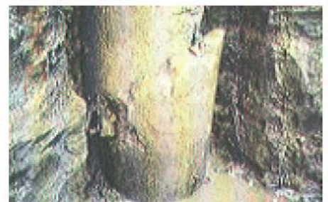
杭の破壊事例
