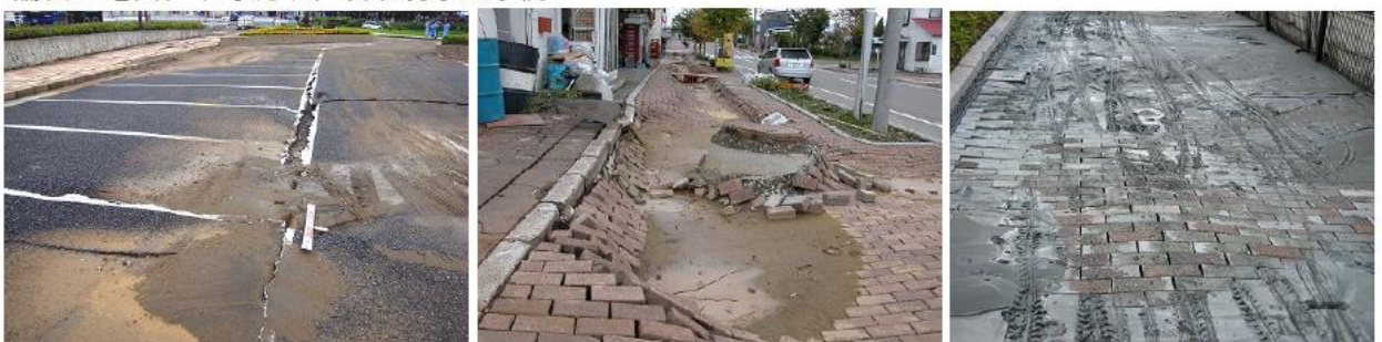
舗装の亀裂、不等沈下、噴砂現象の事例
