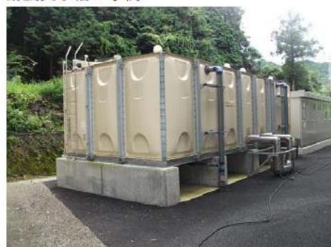
耐震受水槽の事例
