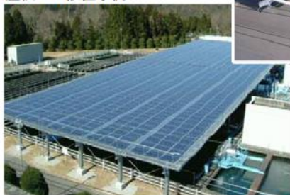
屋根上の設置事例 -1
