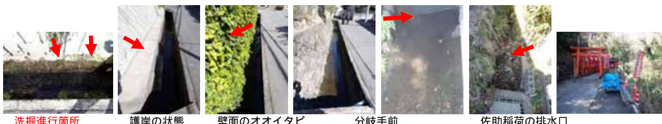
洗掘進行箇所
