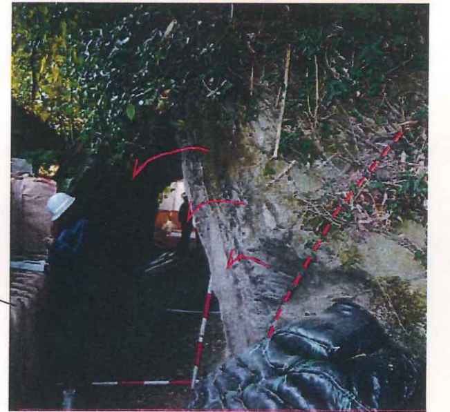
開口クラックに沿って岩盤の転倒・はく落 が懸念される範囲 厚さ: 20~60 cm
