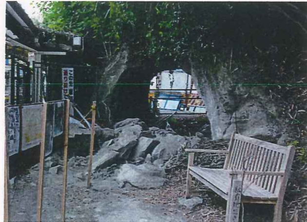
写真 3.3.2 H28.8.12 はく落直後の状況
