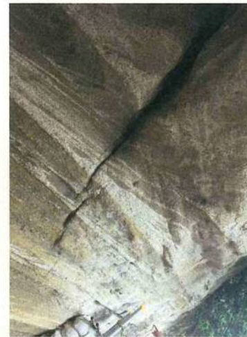
③ 鎌倉側坑口山側のひび割れ状況
