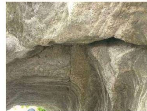
④ ひび割れからの樹木の根
