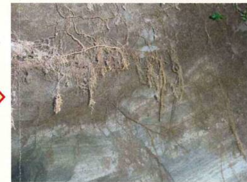
・く落部の樹木の根の状況
