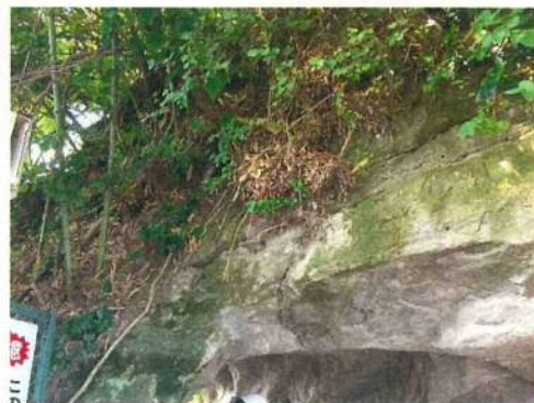
② 鎌倉側坑口上部ひび割れ状況
