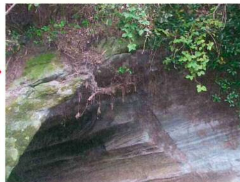
・ひび割れ沿いのく落
