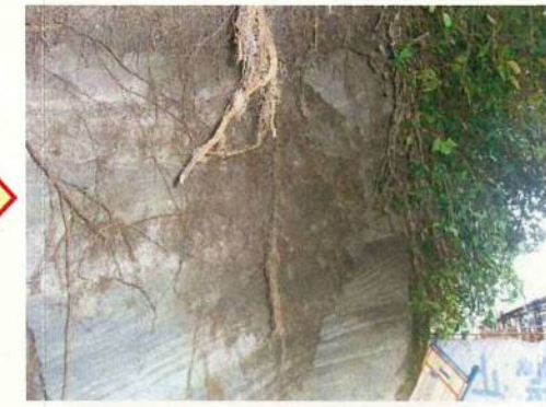
・山側ひび割れ部からのく落状況
