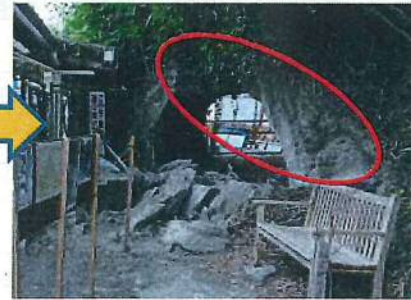
③平成28年8月（はく落直後） ・鎌倉側坑口右肩部のはく落（岩盤） ・さらにはく落する可能性あり
