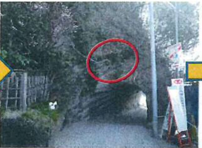
②平成26年3月 ・大船側坑口上部のはく落（岩盤）
