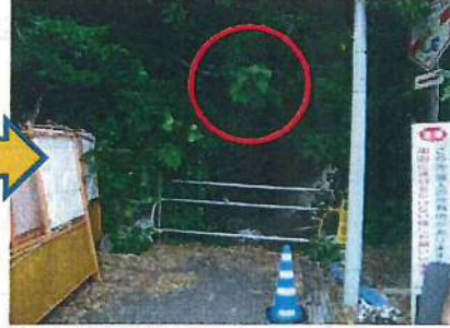
③平成28年8月 ・植生の繁茂が著しい ・はく落する可能性のある不安定岩塊あり
