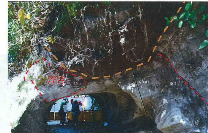
天端の層理面に沿った分離面 (はく落跡) 分離面沿いに浮きや亀裂が見られ、はく落が懸念される
