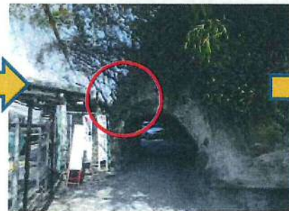
②平成26年3月 ・鎌倉側坑口左肩部のはく落（土砂） ・トンネル内部のはく落、ひび割れの進行
