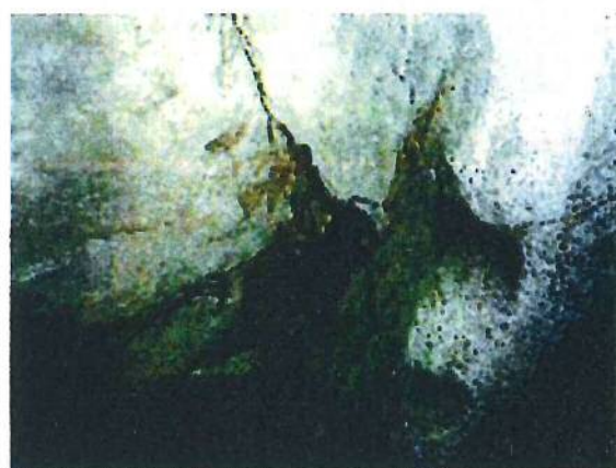
写真-3 樹根貫通と周辺地盤
