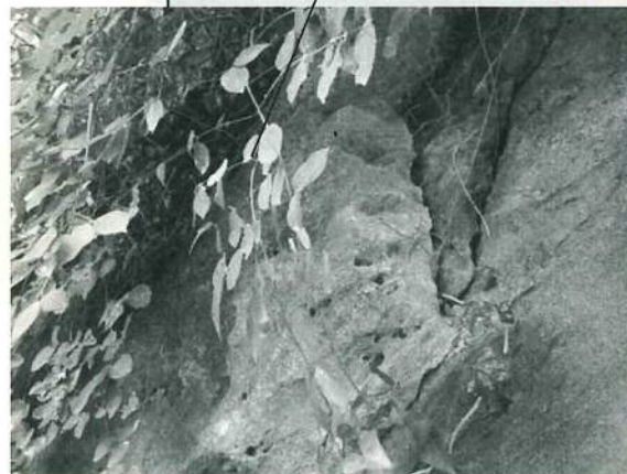
坑口側部の岩壁面に沿った板状の浮き 厚さ：20~30 cm
