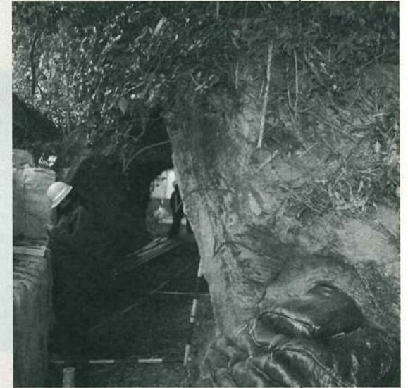
開口クラックに沿って岩盤の転倒・はく落が懸念される範囲 厚さ：20~60 cm
