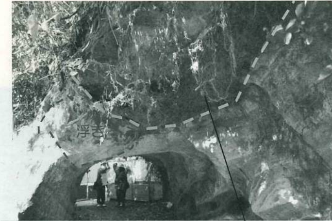
天端の層理面に沿った分離面（はく落跡） 分離面沿いに浮きや亀裂が見られ、はく落が懸念される
