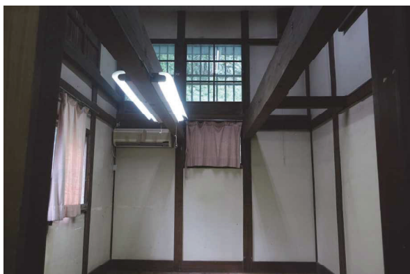
蛍光灯（壁付け）
