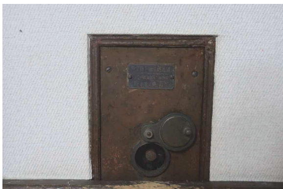
1 階ポーチ シャッター
