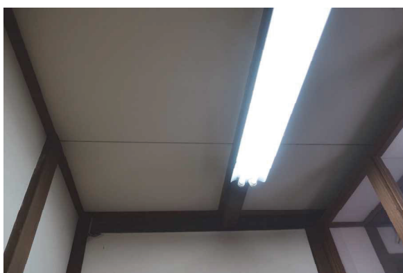
附属棟室 蛍光灯（天井付け）
