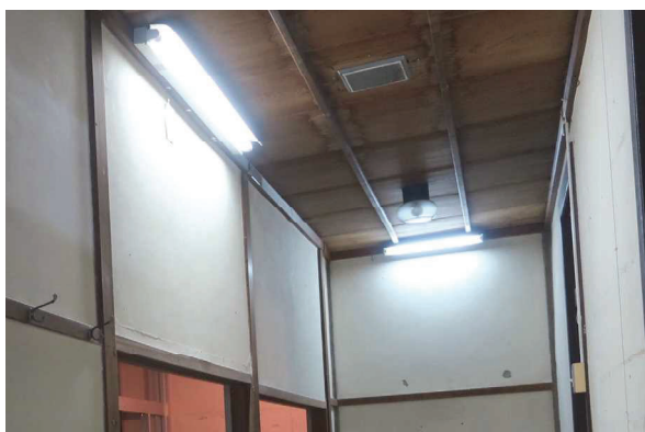
廊下 蛍光灯（天井付け）
