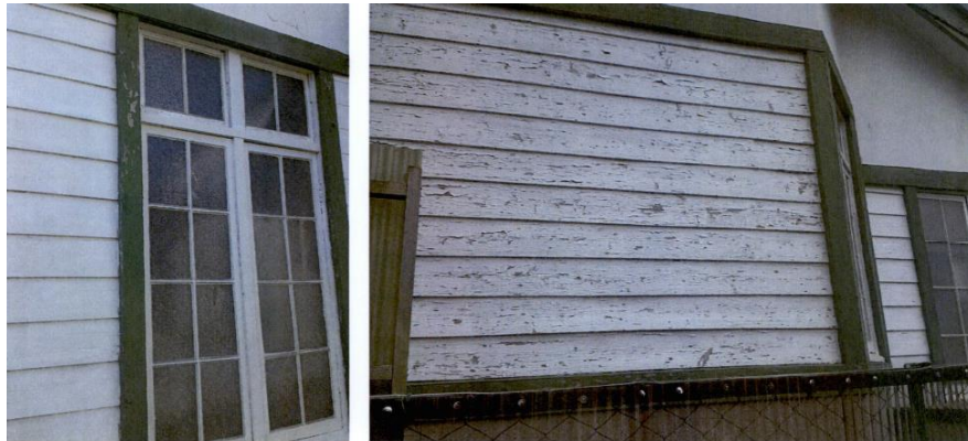
鎌倉聖ミカエル教会聖堂 外壁修繕前
