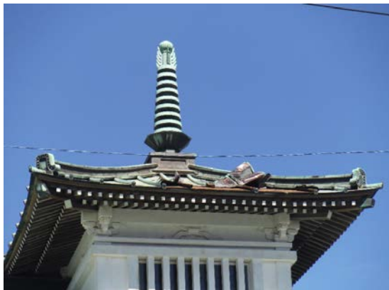
寸松堂 修繕前
