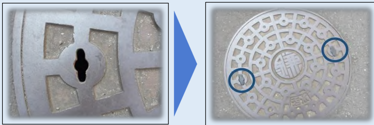
ゴムキャップによる雨水浸入対策
