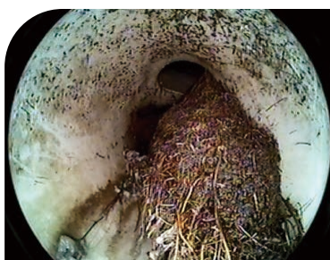
木の根が侵食した下水道管
