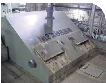
老朽化した 浄化センター内の設備
