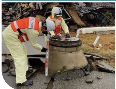
能登半島地震の影響で 浮上したマンホール (提供：静岡県浜松市上下水道総務課)
