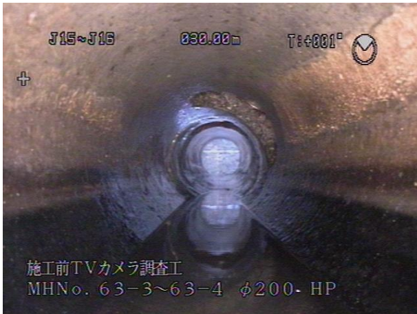
施工前の管の状態
