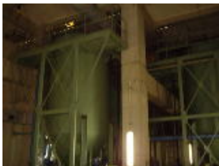
山崎浄化センター砂ろ過施設
