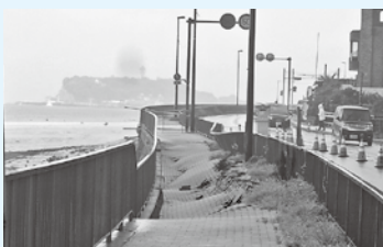
沈下した歩道の状況
