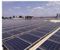
太陽光パネル
