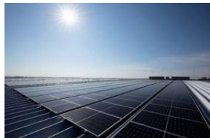
屋上太陽光パネル
