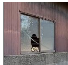
窓が割れた管理不全空家
