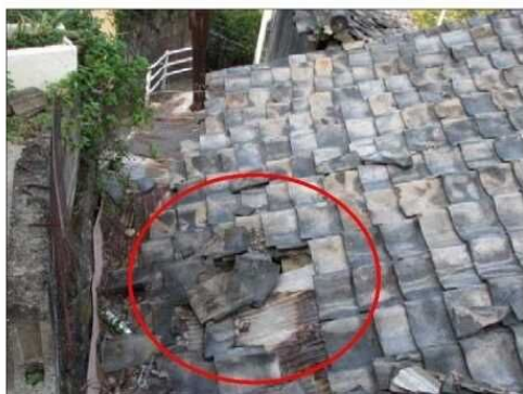
瓦の一部に剥離とズレがあり、 雨漏りのある例
