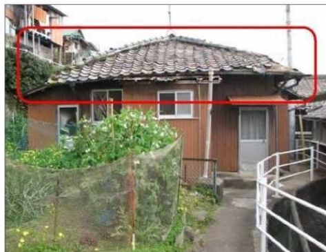
屋根に不陸がある例
