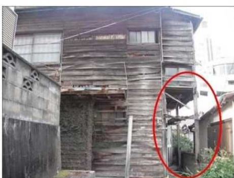
柱の数箇所に破損がある例
