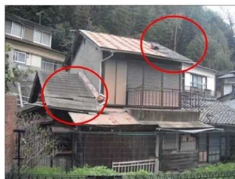
アスファルト屋根等の一部に ズレがあり、雨漏りのある例
