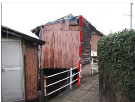
一部の柱が傾斜している例
