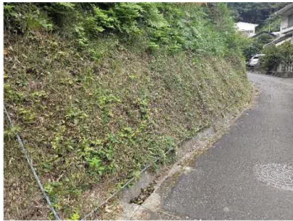
覆式落石防護網【既設】 （急傾斜地③西側箇所）
