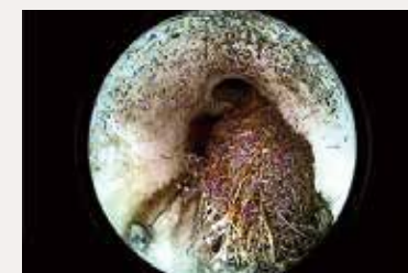
根っこが入り込んで破損した下水道管
