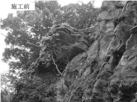
雪ノ下での斜面上部の浮石の状況
