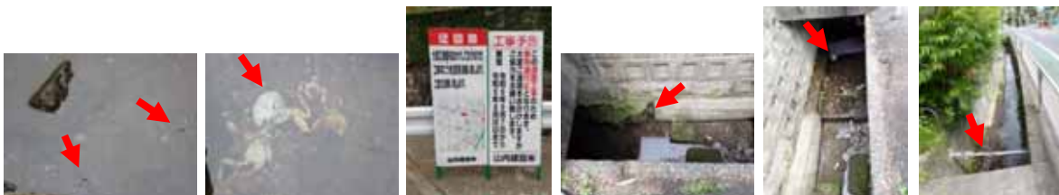
▲シマアメンボ群れ ▲モクズガニの死骸 ▲道路工事の予告 ▲右岸の洗掘箇所 ▲泡は少ない ▲配管の被覆が破損したまま
