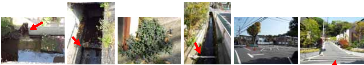
▲右岸の洗掘箇所 ▲泡は見られず ▲キランソウ大株 ▲配管の被覆が破損したまま ▲駐車場 ▲宅地造成地の横断側溝
