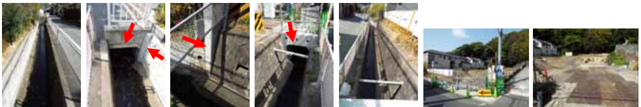
▲増水時に流れを阻害し床下浸水のリスク▲
