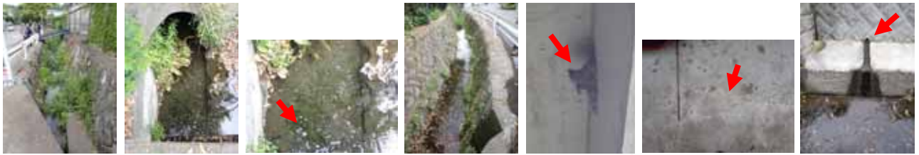
▲佐助自治会館前 ▲税務署裏の落ち口 ▲泡が目立つ ▲下流側 ▲壊されたツバメの巣 ▲糞も見られず ▲最下流の水抜き管
