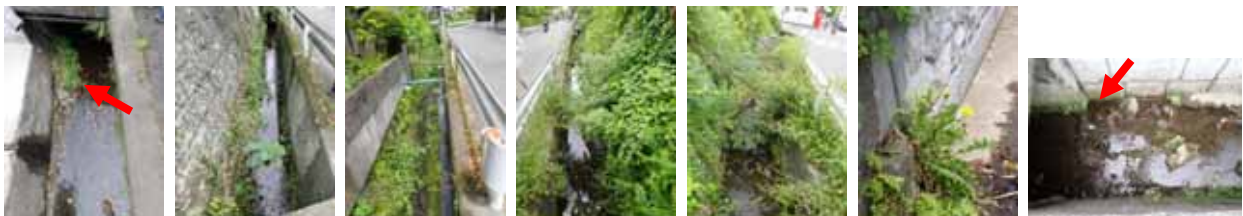
▲流出したモルタル ▲エコアップ箇所 ▲上流側から ▲元・うな豊の前 ▲セイヨウタンポポ ▲右岸の洗掘進行箇所
