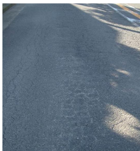
図 2-9 MCI=2 ひび割れが全面にひろがり、 わだち掘れが顕著
