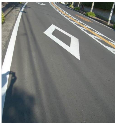
図 2-4 MCI=6~7 ひび割れ、わだち掘れがない程度
