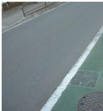
図 2-5 MCI=6 ひび割れがわずかにある程度
