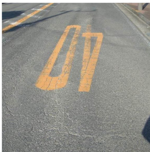
図 2-8 MCI=3 ひび割れが面状にひろがり、 わだち掘れがある
