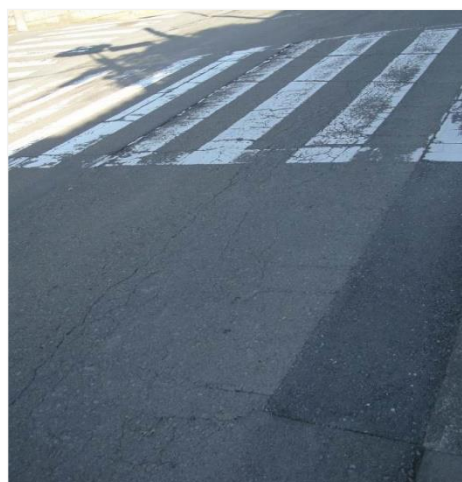
図 2-7 MCI=4 ひび割れが複数ある程度
