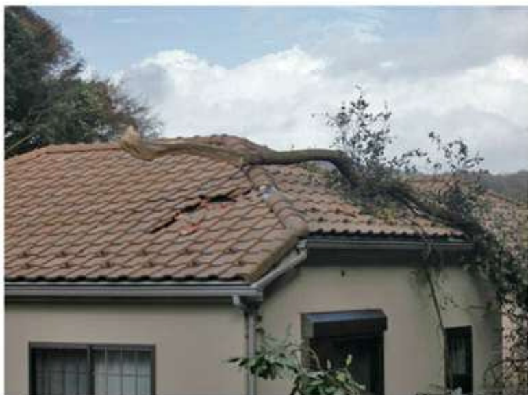
倒木による家屋への被害
