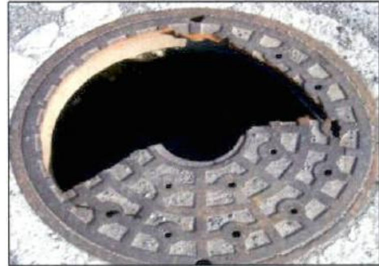
耐用年数を超過し破損したマンホール蓋
