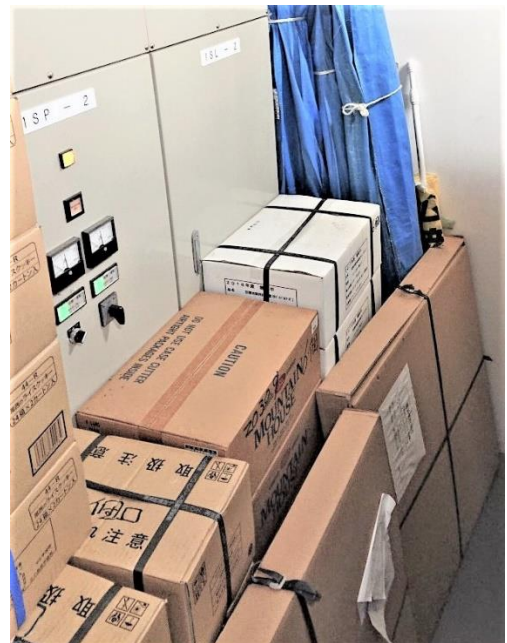
【写真7】配電盤前の物資（大船中学校）
