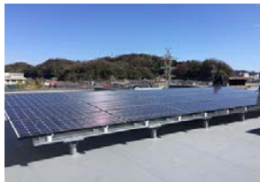
玉縄行政センター 太陽光発電設備
