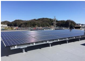
玉縄行政センター 太陽光発電設備
