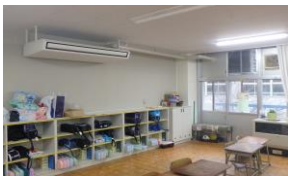
山崎小学校 普通教室冷房設備
