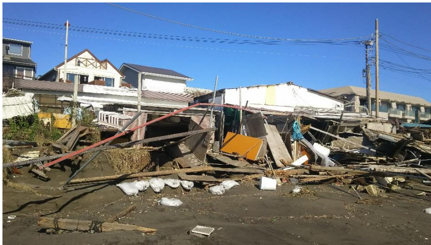
〔材木座地区の漁具倉庫の被害状況〕
