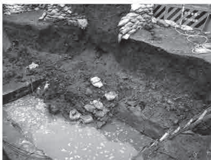
▲ 4. 崩落状況 (南東から)
